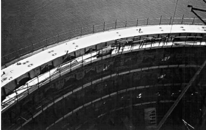
Hình 13.6: Các kết cấu đúc sẵn đập phá sóng giàn khoan dầu trung tâm Ninian xây dựng cùng với đường đi cố sẵn
