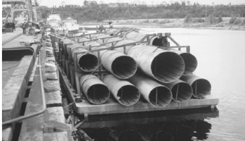
Hình 14.3: Xe vận chuyển cọc từ Seattle đến Alaska. Chúng được neo giữ chặt trên xe
