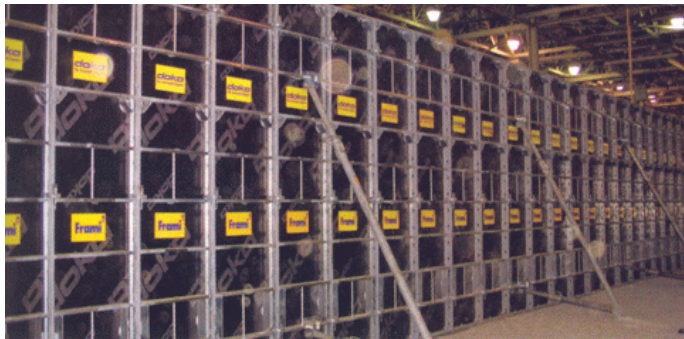
Hệ ván khuôn Frami dùng để thi công cải tạo nhà xưởng hãng Ford
