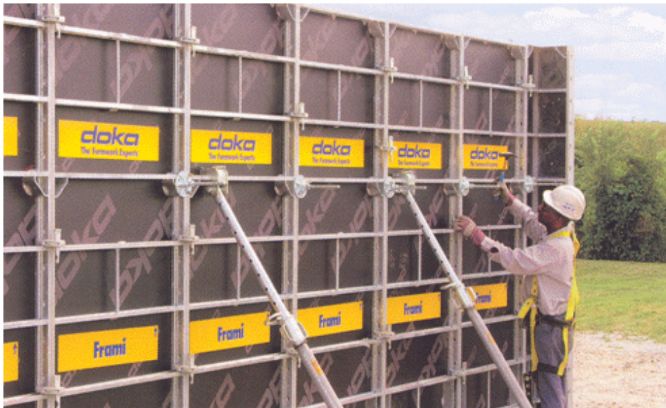
Hệ ván khuôn mới Frami dùng để thi công các tường cao bằng phòng
